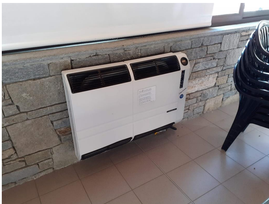
Uno degli aerotermini a parete attualmente installati
