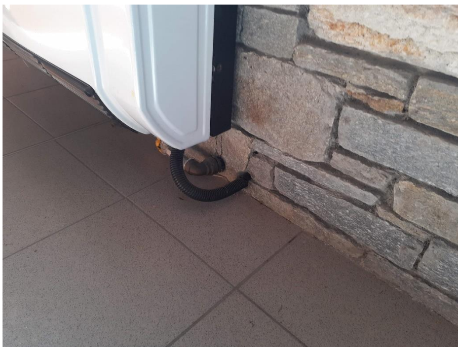
L'attuale collegamento alla linea gas, che alimenta direttamente il singolo aerotermo
