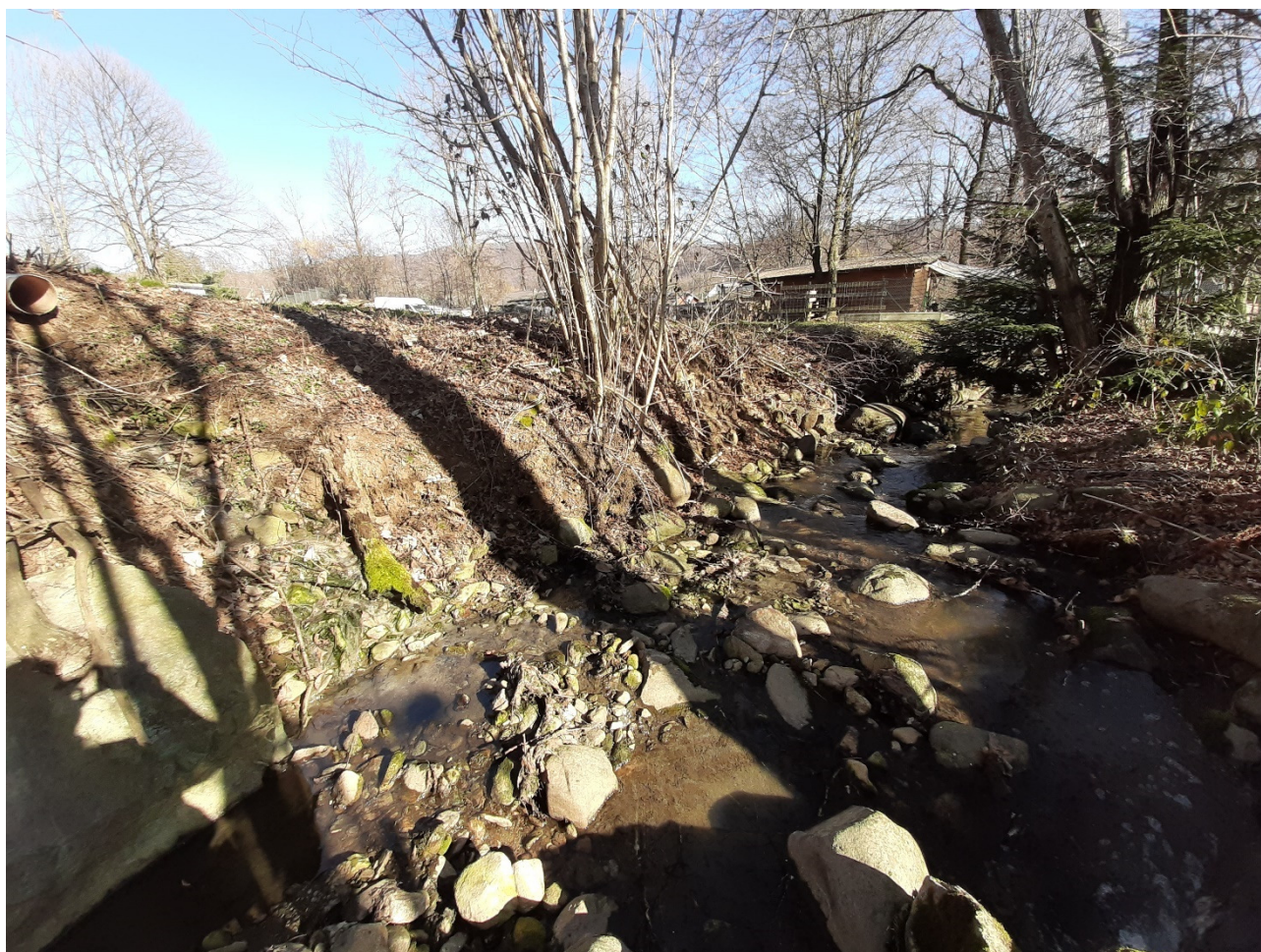
Foto 1: Sponda in erosione
