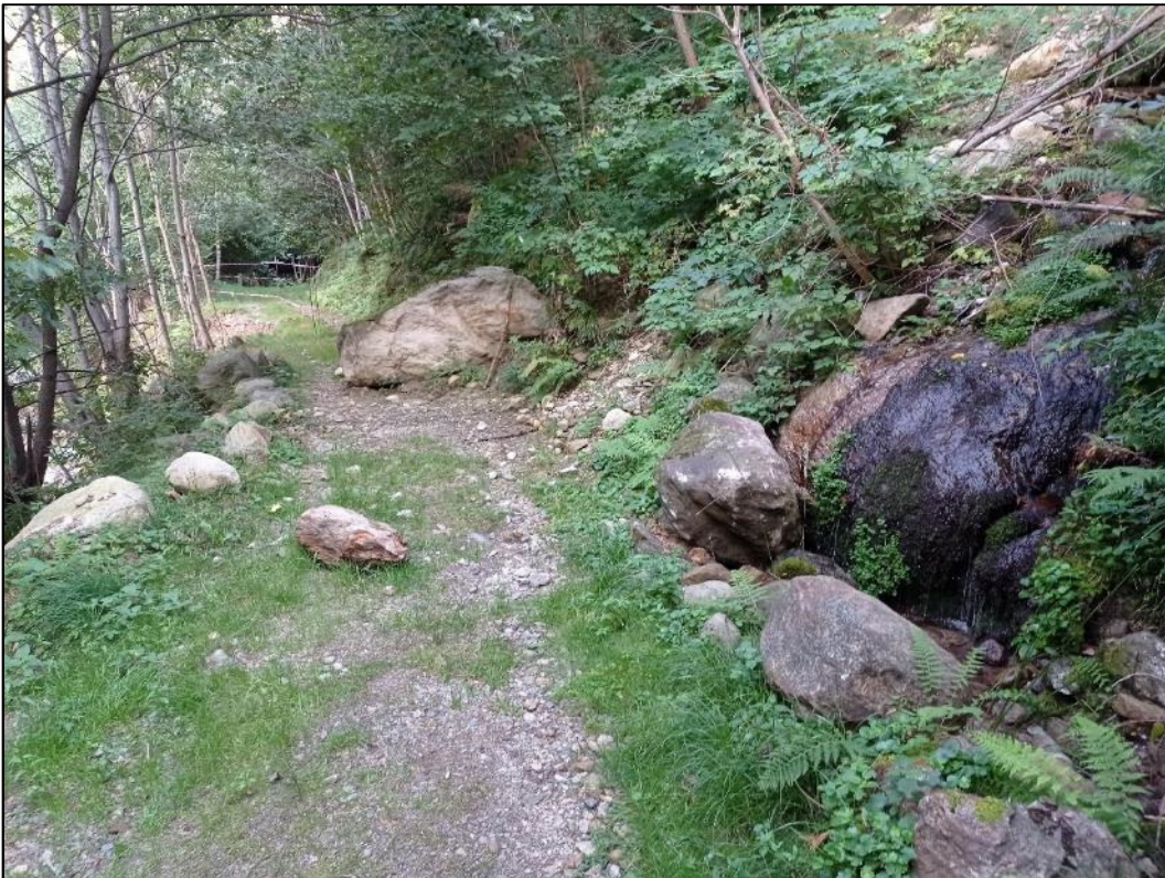
Nota esplicativa: Foto 8. Versante franato a monte della pista esistente, vista da ovest.
