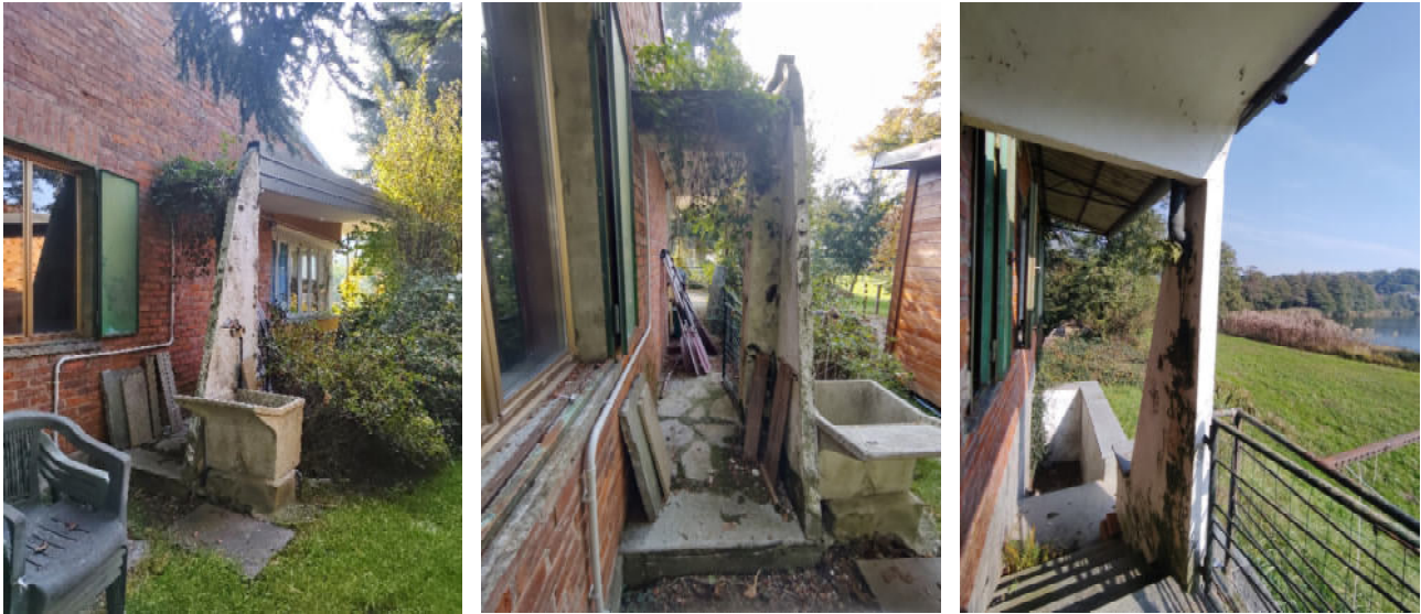
Fig. 5. Situazioni di degrado del fabbricato esistente ad uso laboratorio didattico.
