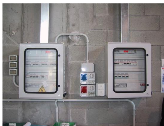
Esempi di quadri elettrici posizionati in centrale termica
